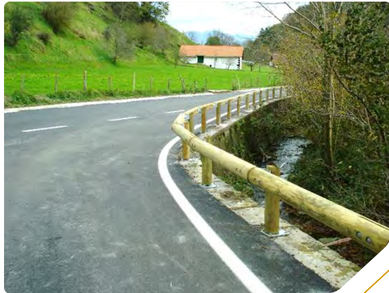
Route départementale – S42 sur longrine béton
